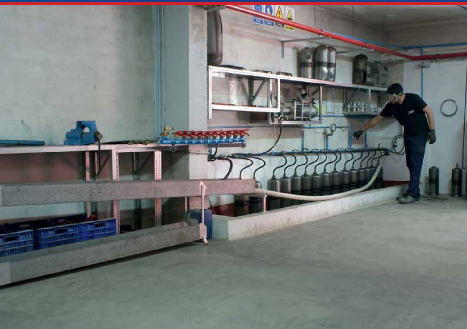
Área de pruebas hidráulicas y retimbrados
